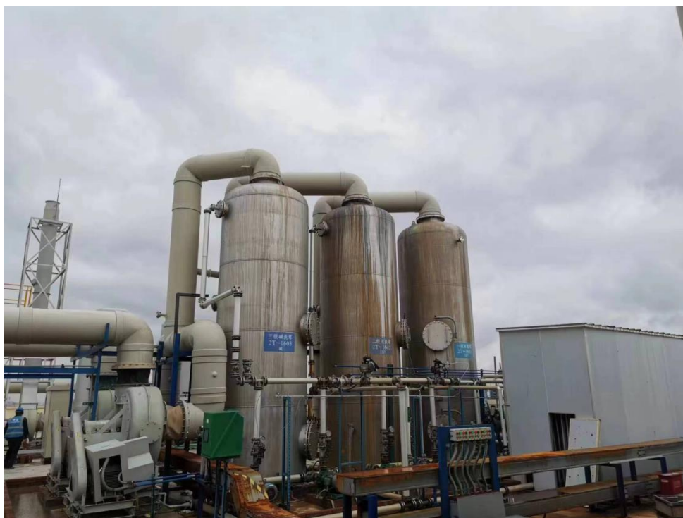
图 4.1-3 废气处理设施
