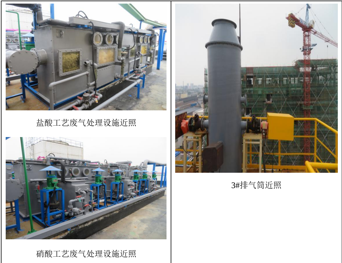
图 4.1-3 项目废气处理设施
