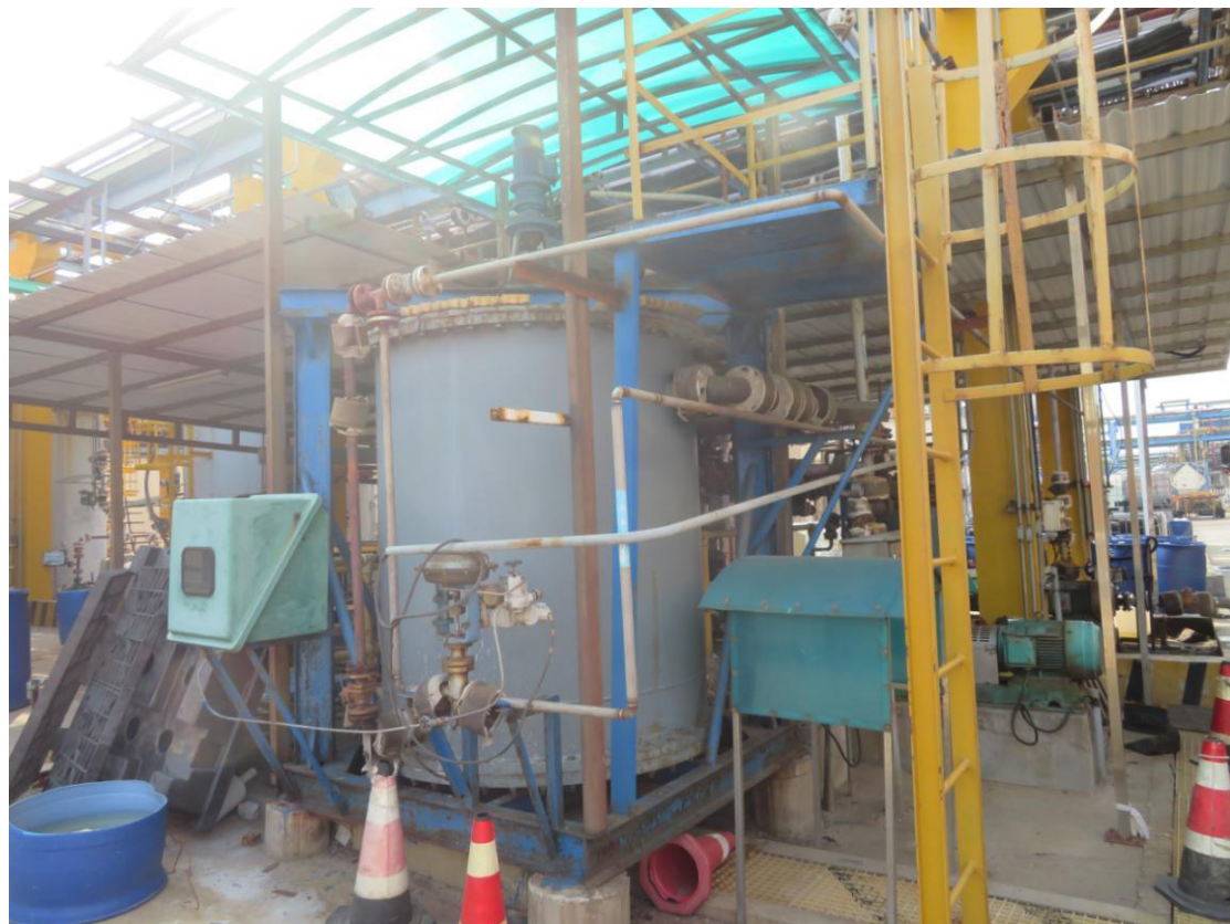
污水处理设施照片
