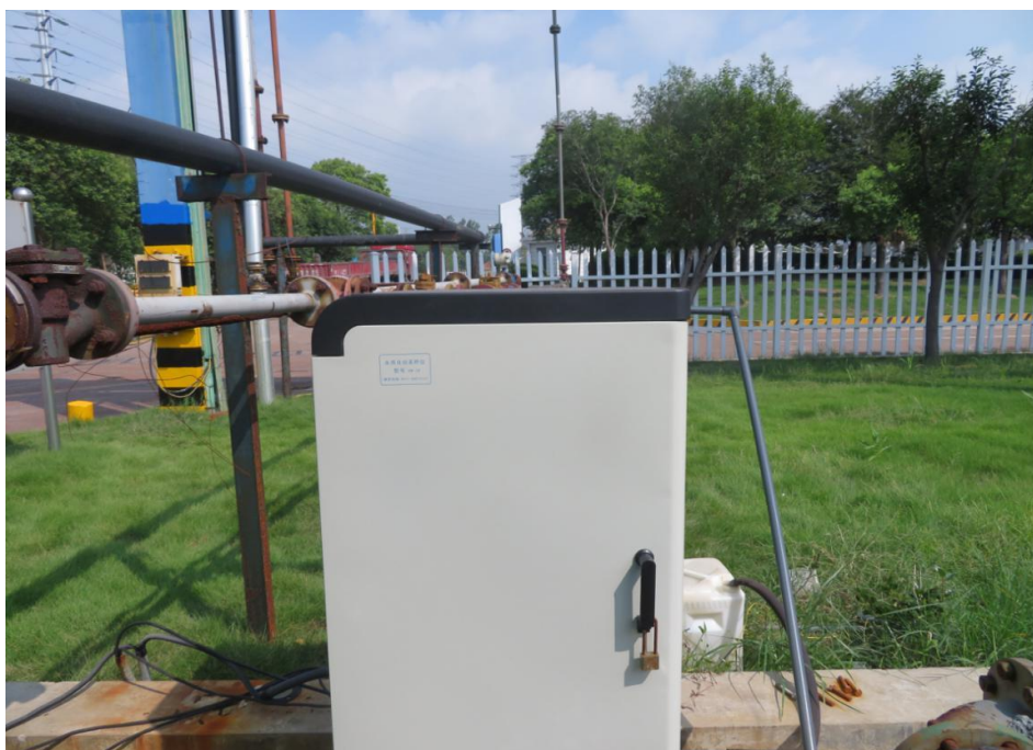
污水站在线监测系统照片
