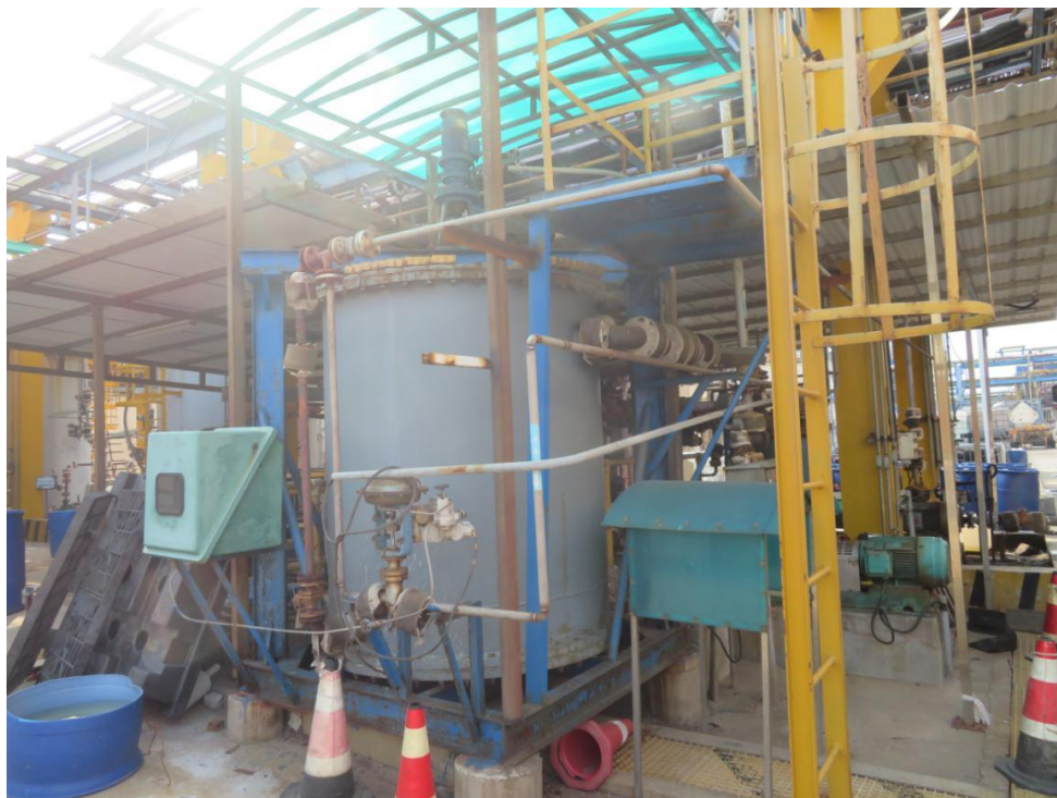
污水处理设施照片
