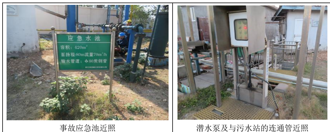
图4.2-1 事故应急池及配套设施近照
