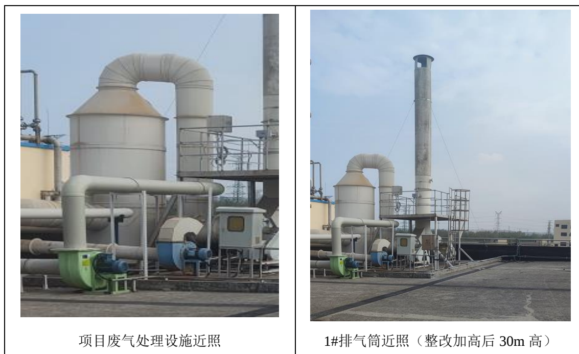
图 4.1-4 项目废气处理设施
