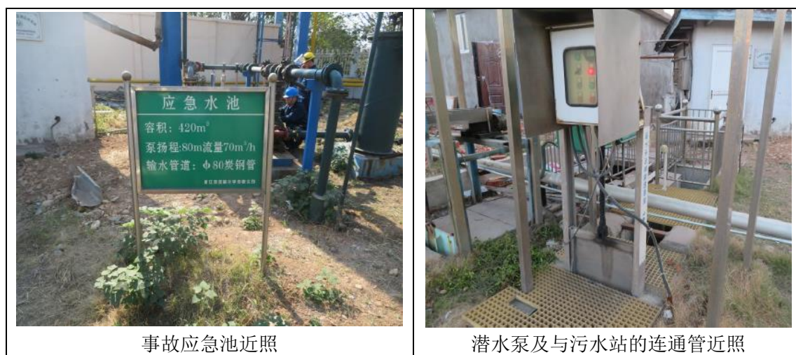
图4.2-1 事故应急池及配套设施近照
