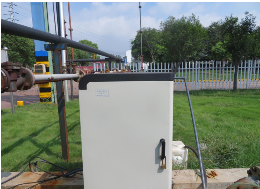
污水站在线监测系统照片
